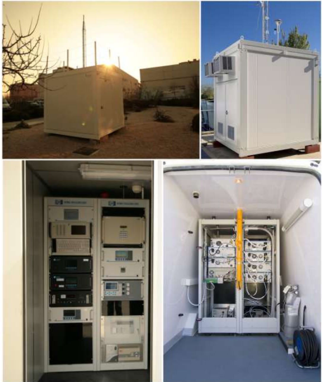
Figura 24. Cabinas de monitoreo equipos automáticos
